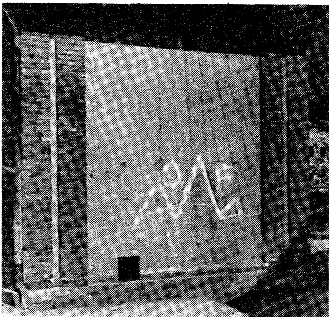
Znak OF na transformatorski postaji v Trnovem.
