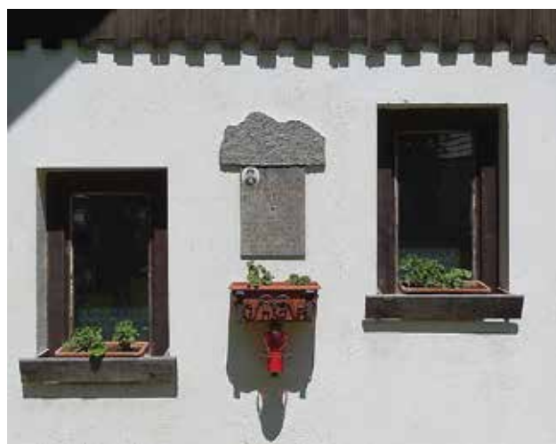
Plošča na fasadi planinske koče pred obnovo (foto: Dušan Bavčar).
